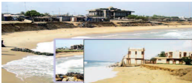
Destruction de constructions côtières : hôtel Palm Beach en ruine. Photo n°18, K.S. ADAM et al, 2007, p.27
