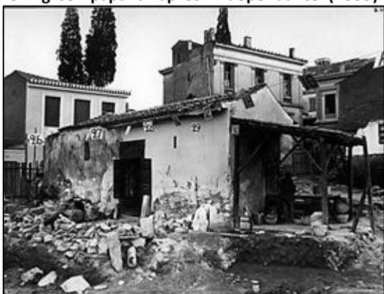
Fig. 6 : Église Agíoy Spyridōn au moment de sa démolition pour les fouilles de l'Agora (1931-1935)
