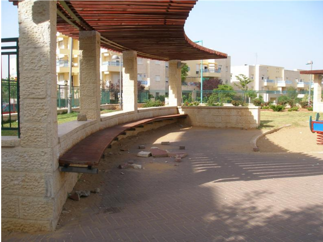
Photo 21 Abri vandalisé (Elad, 2009)
