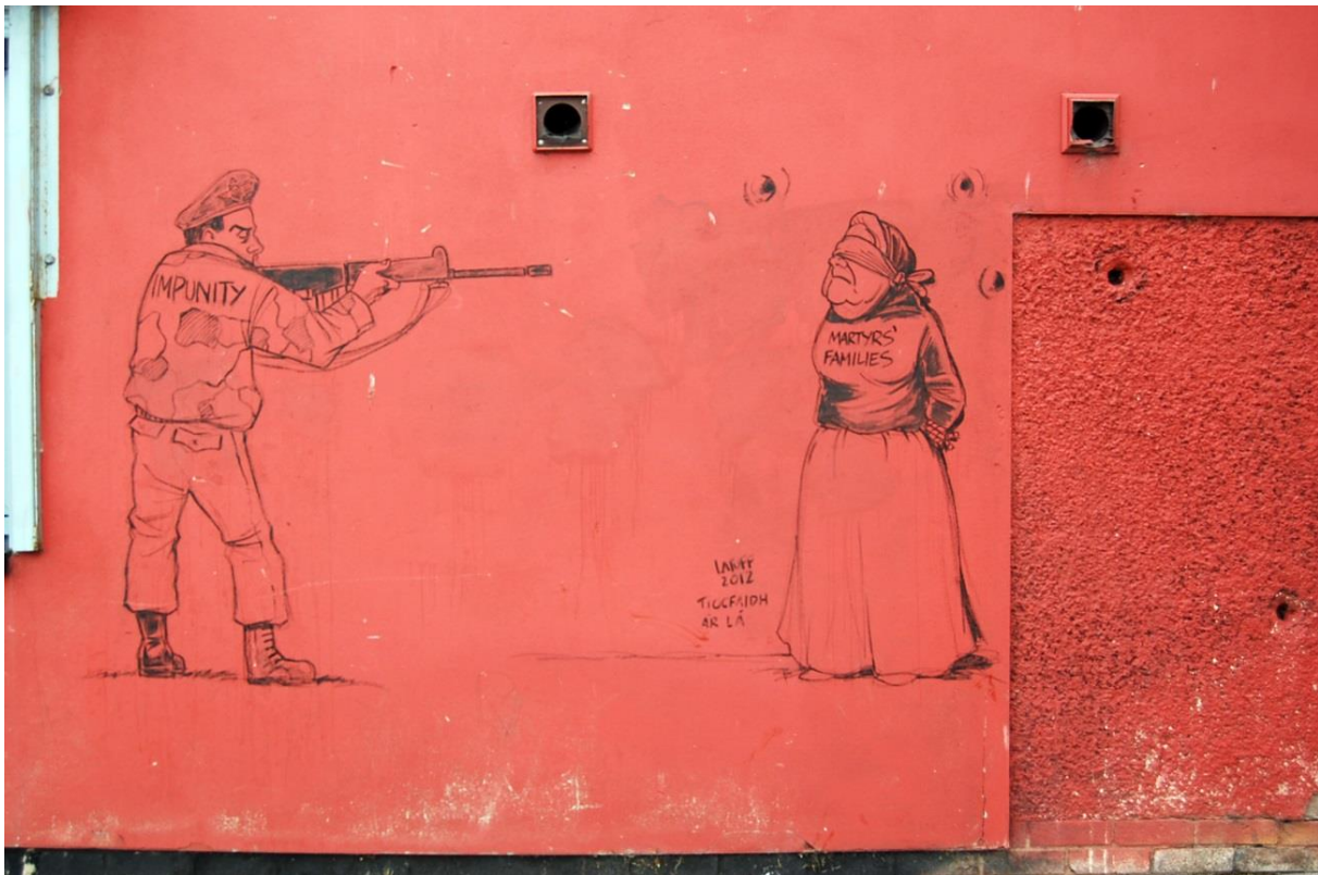
Figure 114 : Les impacts de balles sur le mur du Museum of Free Derry
