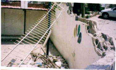
Jénine : destruction aire de sport
