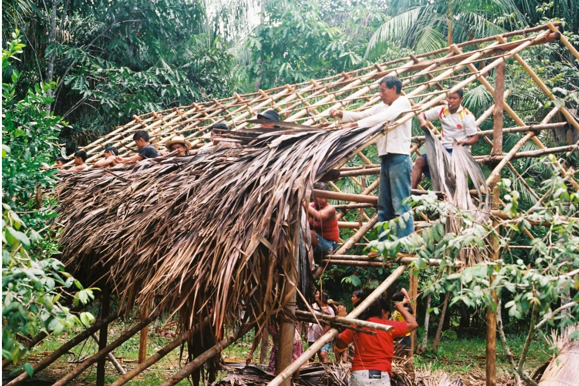
Photo 36 : construction de la casa de apoio , au premier plan, le maître d'œuvres, Adão. ©Emmanuel Richard, 2017.
