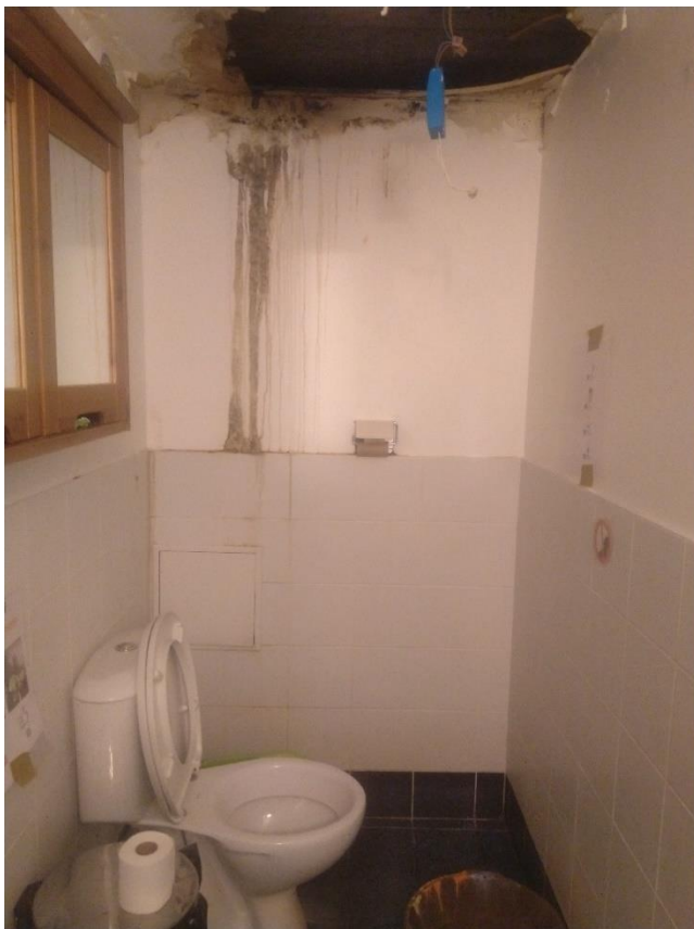
Image 5 : sanitaires de l'association Carton Plein, photo envoyée pour le constat de sinistre, présente sur le Drive de l'association.
